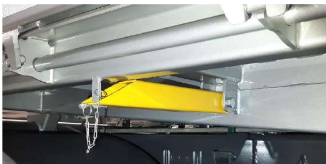
Rys. 9. Zawleczka zabezpieczająca podporę naprawczą w wywrotce trójstronnej
